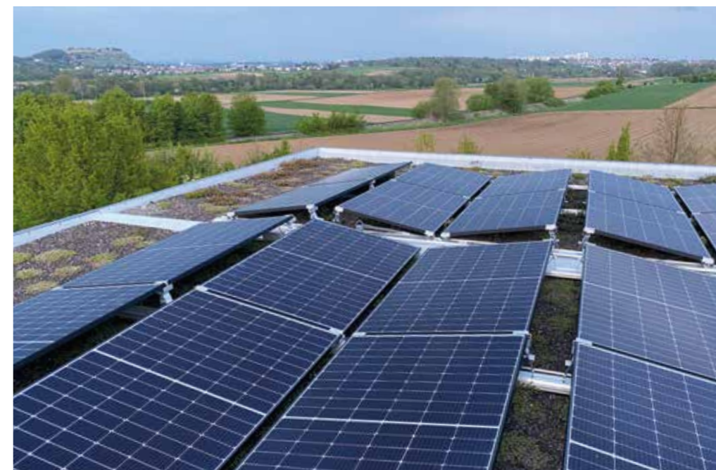
Photovoltaik-Anlage versorgt uns an den allermeisten Tagen mit 100% Eigenstrom
